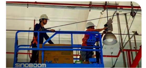
• 侨城东车辆段检修库照明灯具节能改造
